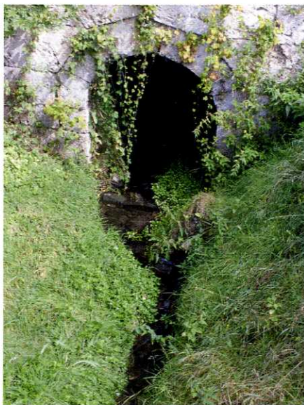
Ce qu'il reste du Lava-Péchon : un filet d'eau qui s'insinue entre la sortie d'un drain et le mur de soutènement de l'ancienne route de Morat.
