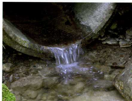
Le 25 avril 2011, dans un goi à la sortie d'un tuyau traversant un chemin...
